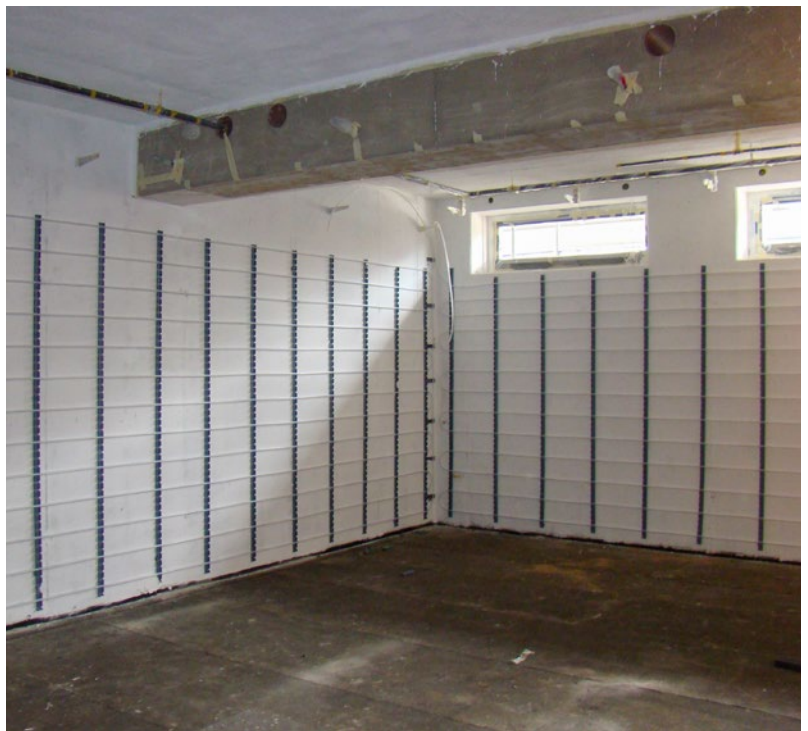
Bild 2 Heizungsregister im Depot des LVR-Archäo- logischen Park Xanten
